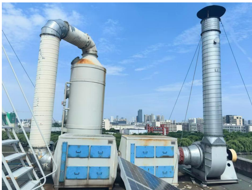
图 3.2-1 企业上胶废气排气筒（DA001）
