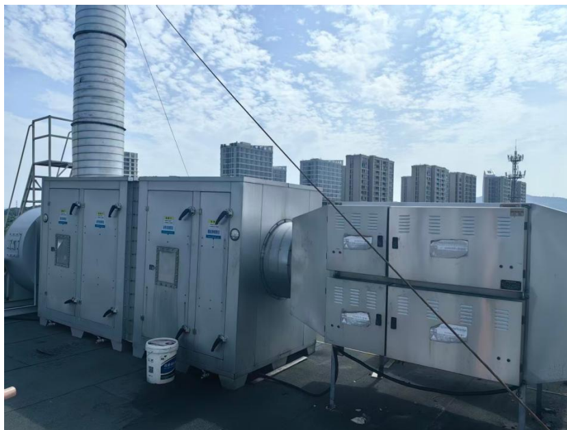
图 3.2-2 企业固化废气、辊压、预成型、成型、烘烤废气排气筒（DA002）
