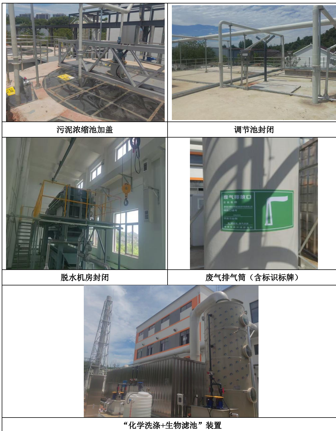
图 4.1.2-2 废气处理装置照片
