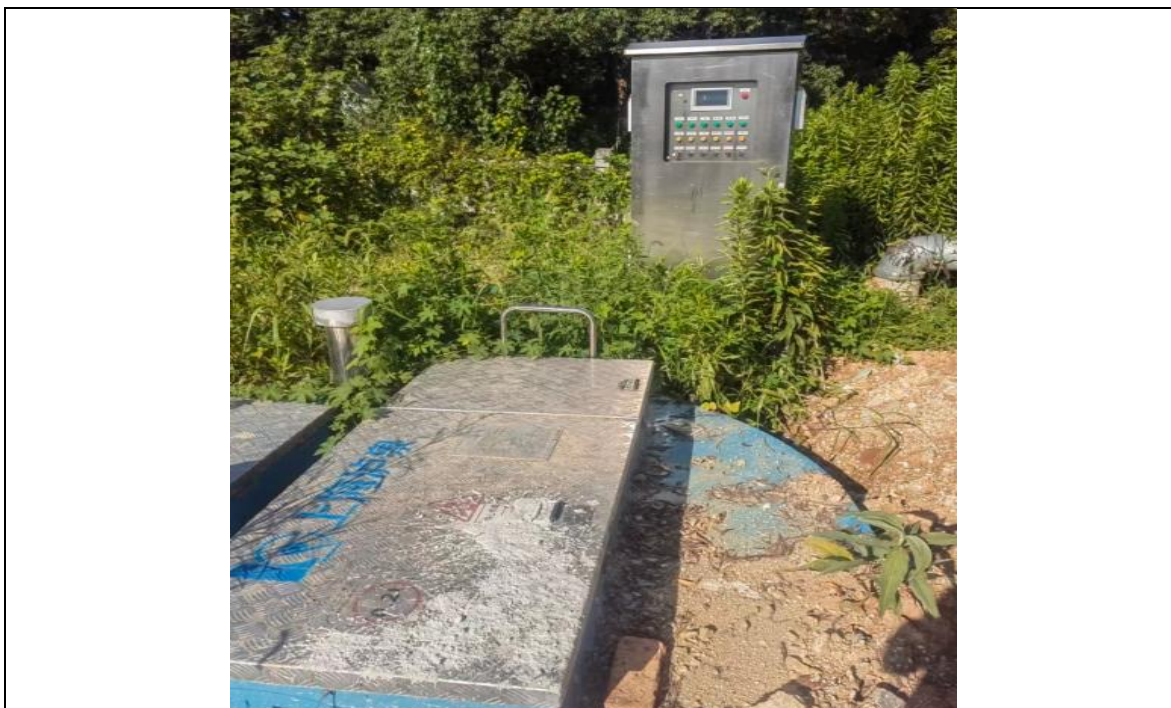
提升泵站照片
