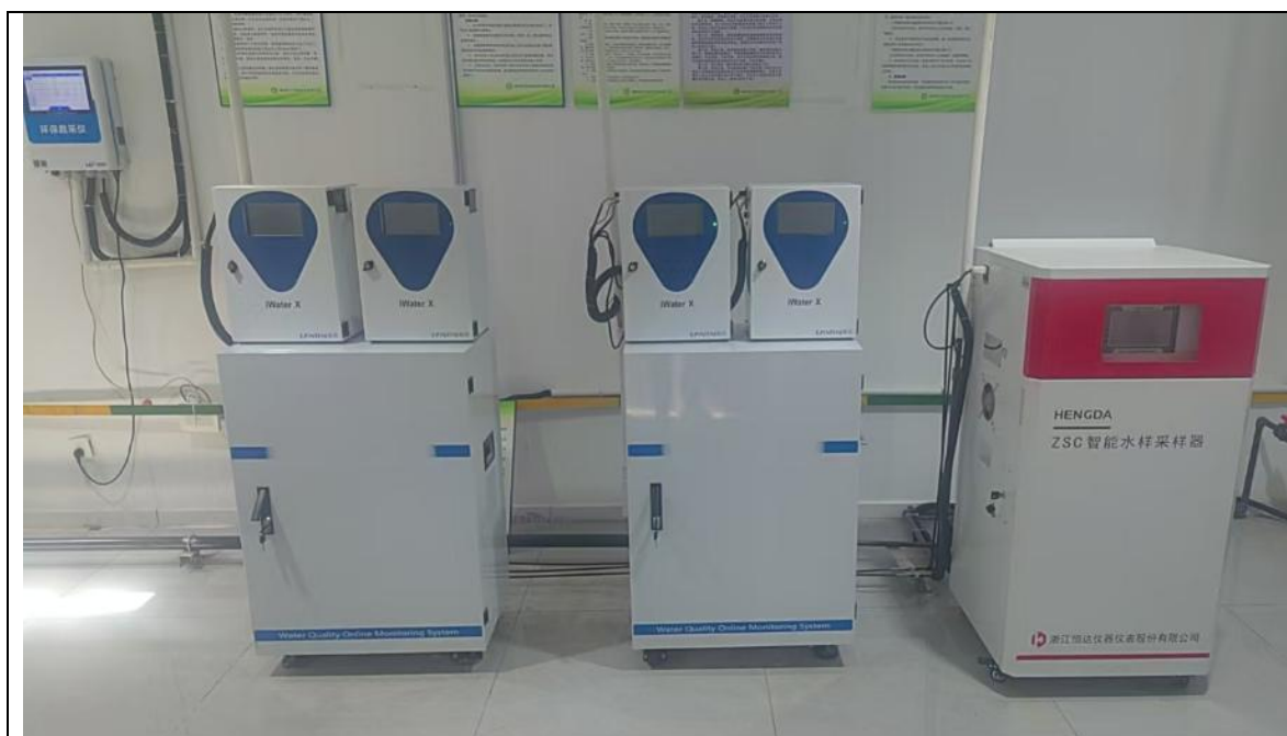
废水总排口在线监测设备照片
