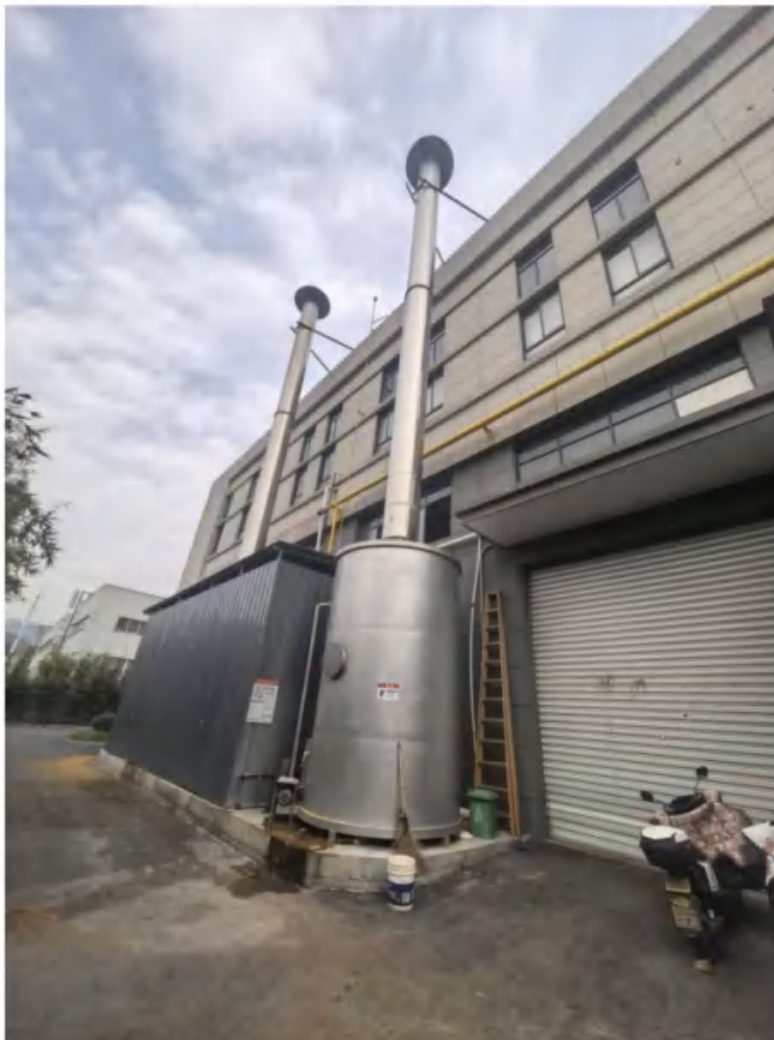
图 3.2-1 企业干燥粉尘、热风炉燃烧废气排气筒（DA001、DA002）
