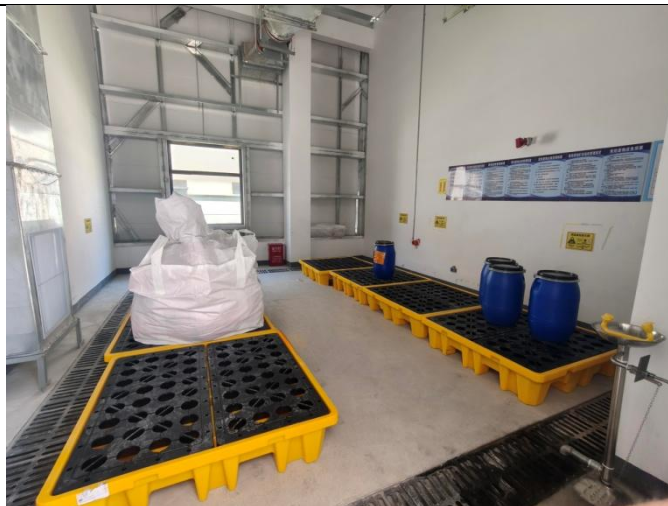
图 3.1-3 危险废物暂存仓库照片
