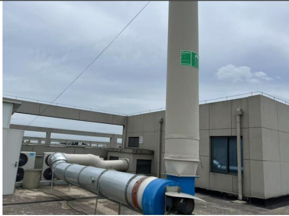
焊接粉尘与喷胶废气、丝印烘烤废气（含丝印网版清洗）、激光切割废气合并的排气筒
